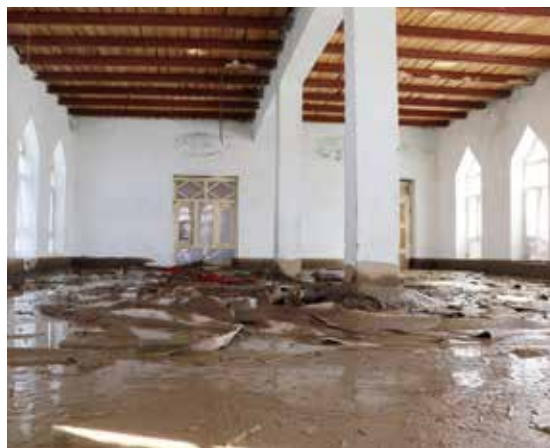
Auch zahlreiche öffentliche und religiöse Gebäude wurden von den Wassermassen beschädigt.
