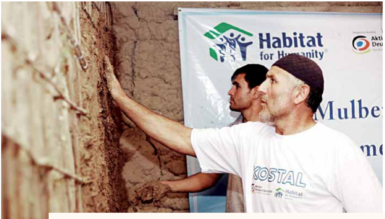
Mit der sogenannten „Mulberry Twig Technology“ wurden die Lehmhäuser gegen Erdbeben gesichert.
