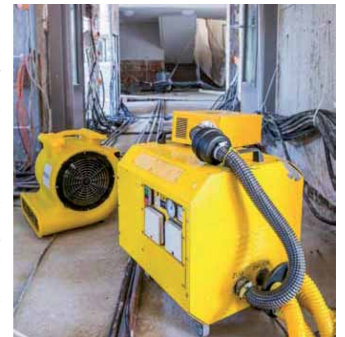
Im Erdgeschoss der Johanniter-Kita laufen die Trockner auf Hochtouren.
